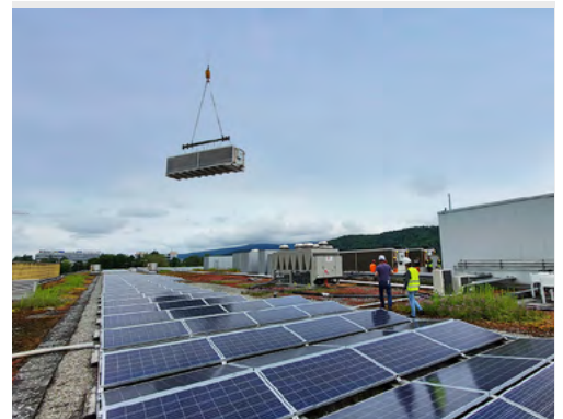
IKEA in Spreitenbach: Technische Bauherrenberatung für Energiecontracting
